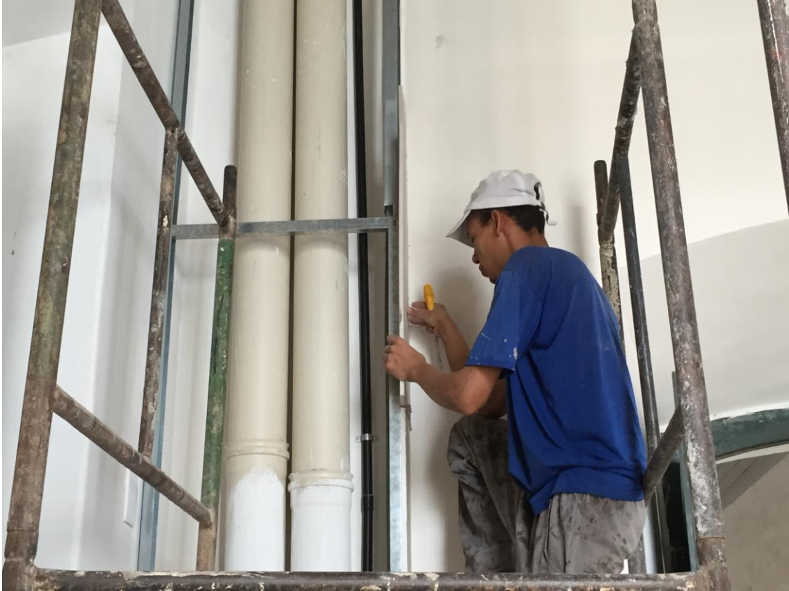
Foto 02: Shaft com tubulação e exaustores para a troca de AR QUENTE X AR FRIO das condensadoras de ar condicionado no depósito abaixo da torre sineira esquerda.
