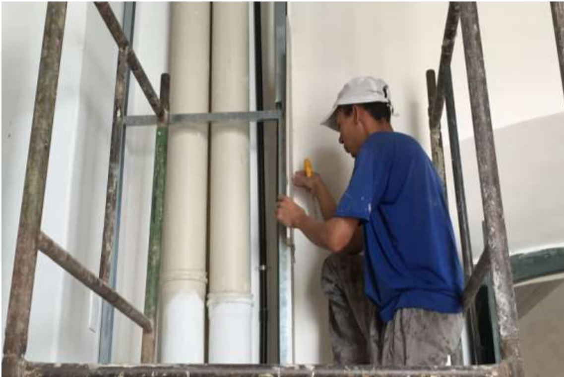
Foto 02: Instalação e montagem do chaft para fechamento da tubulação para exaustão do ar quente das condensadoras de ar condicionado que se encontram no depósito abaixo da torre sineira esquerda.
