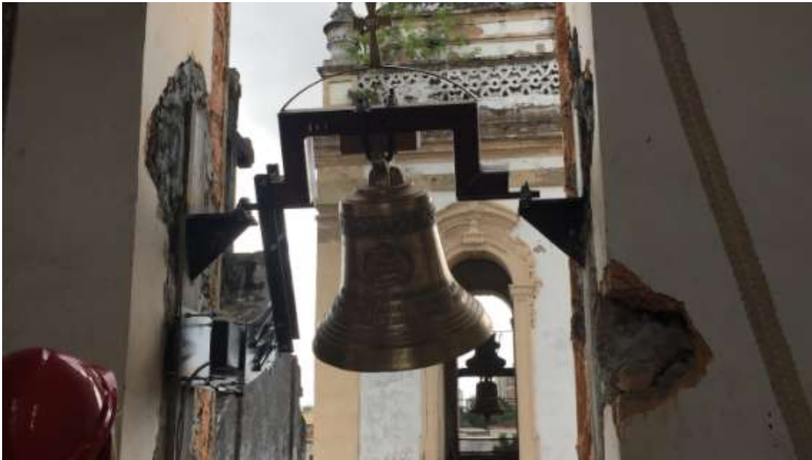
Foto 08: Sino pequeno, voltado para rua do Carro, instalado e automatizado.
