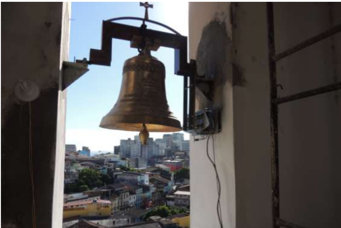
Foto 07: Sino médio, voltado para rua do Tingui, instalado e automatizado.
