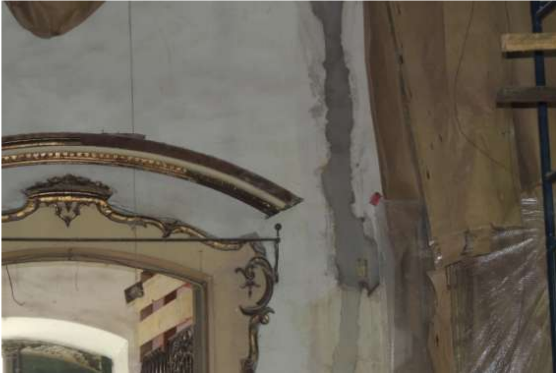
Foto 02: Recomposição dos cortes nas paredes da nave com tubulação e caixas de passagem para instalação elétrica e sonorização.
